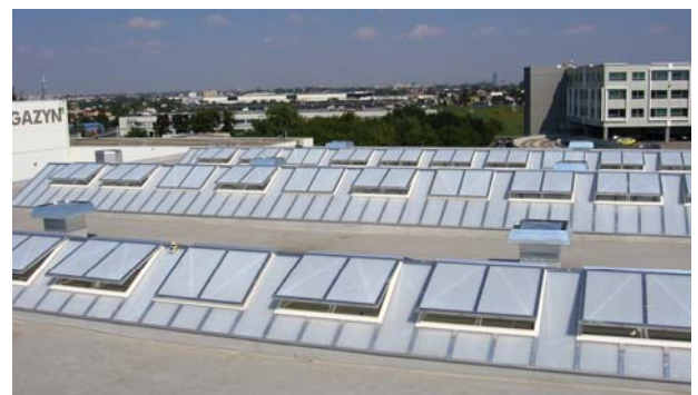
Satteldach- Lichtband opal mit Lüfterklappen
