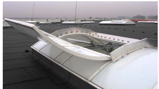
RWA- Einzelklappe mit Windleitwänden
